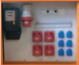
Gut zugänglicher und praxiserichter Steckdosenbereich, Einspeisung über CEE-Gerätestecker
