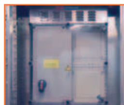
Eingangsseitiger Trennschalter zum Freischalten des Abwärtstrafo
