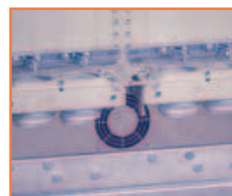
Doppelkabelverschluss mit Kabelschellen, 400V Schalt-raum zwangsbelüftet
