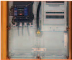
Praxisgerechter und großzügiger Anschlußraum
